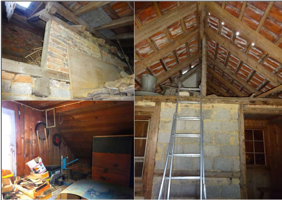
Abb. 4: Verschiedene Eindrücke und Räume im Schuppen. Rechts: der Dachstuhl ist offen und nicht isoliert, es existieren zahlreiche Öffnungen, die als Einflug für Fledermäuse dienen können. Links unten: die Werkstatt ist mit Holzpaneelen verkleidet. Links oben: der halboffene Dachüberstand bietet Fledermäusen (und Vögeln) Zugang zu Spalten im Gemäuer des Schuppens.
