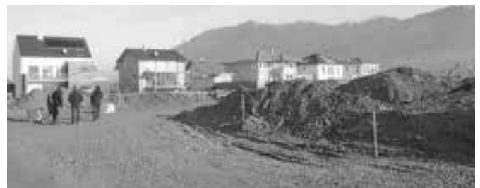
Im Neubaugebiet »Hinter Kirchfeld II« ist der Bagger im Einsatz – vor dreieinhalb Wochen wurde hier mit den Erschließungsarbeiten begonnen.
