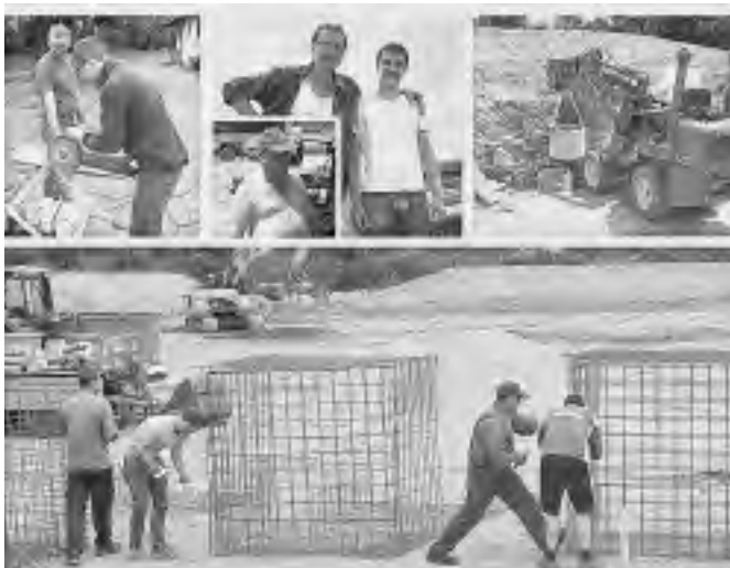
Die Fotos zeigen (oben, von links) wie die Stahlrohre für die Umrandung zugeschnitten wurden; daneben die Verantwortlichen für die richtige Betonmischung Piet Werner und Dominik Schwendemann (von links) sowie Martin Leopold; den Einsatz der von der Familie Schwendemann zur Verfügung gestellten Geräte sowie (unten) wie AH und Aktive die Baustahlkörbe für die Flutlichtmast-Sockel richteten.
